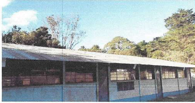
Foto 4: PINTURA. (áreas de salones, cocina, servicios sanitarios y muro perimetral, puertas metálicas, porton y porterías. Se aplicará 1115 m2 de pintura a dos capas, por deterioro de pintura en las áreas descritas.)
