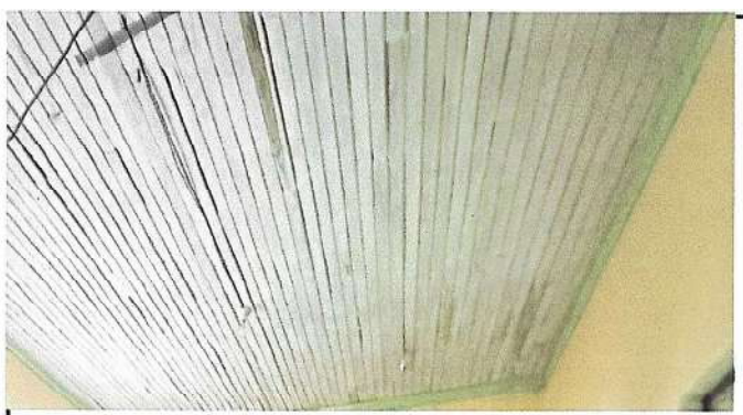
machimbre en mal estado
