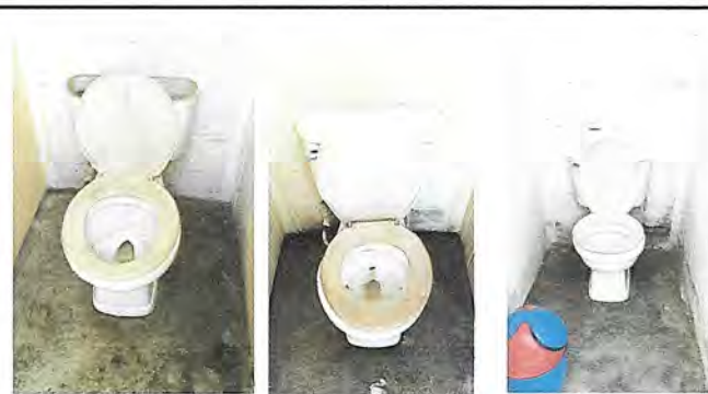
Foto9: SERVICIOS SANITARIOS Y SUS ACCESORIOS (Se realizara el cambio de 6 inodoros y sus accesorios, llave de paso y mangueras, los existentes presentan deterioro, obstrucción y fuga.)
