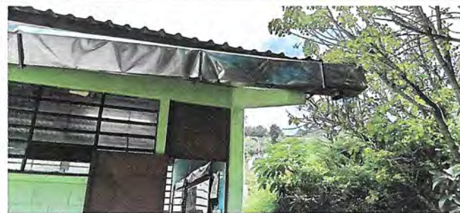
Foto 5:CUBIERTA DE LAMINA (Cambio 40 metros de canal por deterioro y desprendimiento de bajadas de agua pluvial, se colocaran 4 bajadas de agua pluvial de 4" de diametro.)
