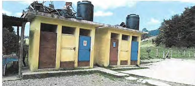
Foto8: SERVICIOS SANITARIOS Y SUS ACCESORIOS (Se realizara el cambio de 6 inodoros y sus accesorios, llave de paso y mangueras, los existentes presentan deterioro, obstrucción y fuga.)
