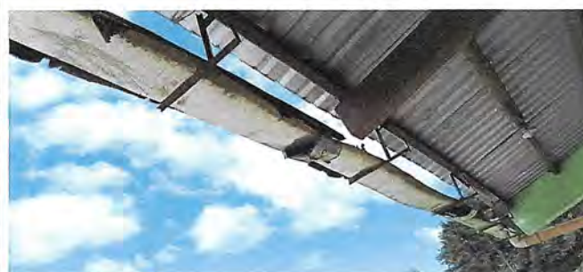
Foto 4:CUBIERTA DE LAMINA (Cambio 40 metros de canal por deterioro y desprendimiento de bajadas de agua pluvial, se colocaran 4 bajadas de agua pluvial de 4" de diametro.)
