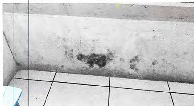
Foto 2: Eliminación de moho a causa de humedad en paredes de aulas
