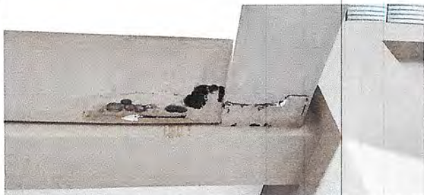
Foto1: Fitración proveniente de juntas de techo de lamina con la loza
