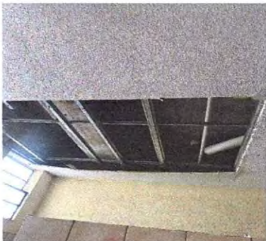
Foto 1: Se realizará el cambio de cielo falso por deterioro y falta de piezas
