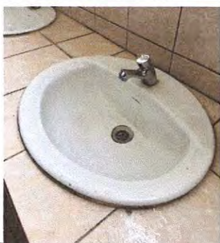
Foto 3: Se realizará el cambio de lavamanos debido al deterioro y fugas de los mismos
