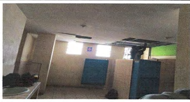
FOTO 2. TECHO, BAÑOS DEL PRIMER NIVEL
