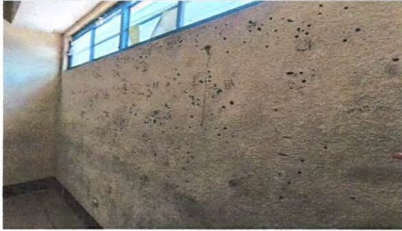
FOTO 1. SALON DE ELECTRICIDAD PRIMER NIVEL
