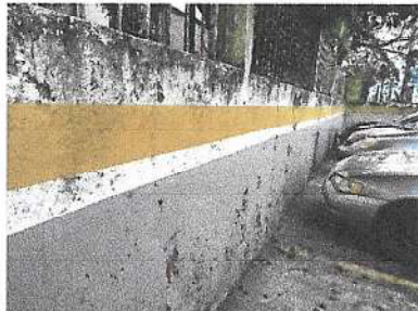
Foto 2: Pintura frente a parqueo en muro perimetral
