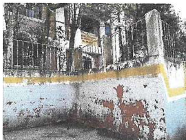
Foto 1: Pintura frente a parqueo en muro perimetral
