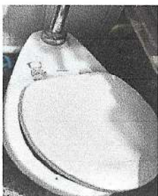
Foto 1: Sustrucción de accesorios varios. Tapadera plástica de sanitario
