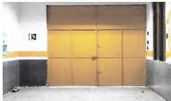
Foto 14: agregar una ventana en el portón principal y un timbre.
