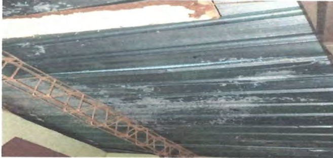
Foto 1: CUBIERTA DE LÁMINA - Salones de preprimaria, techo en mal estado, láminas oxidadas y posee filtraciones de agua.
