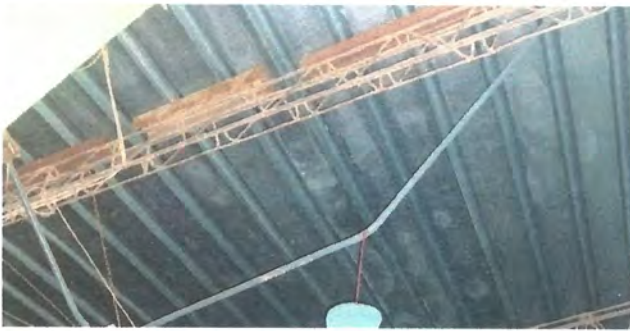
Foto 3: ESTRUCTURA DE TECHO- Salones de preprimaria, la estructura se encuentra oxidada y picada.
