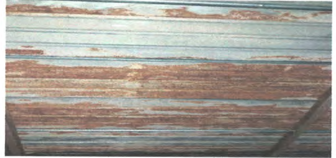
Foto 2: CUBIERTA DE LÁMINA - Salones de preprimaria, techo en mal estado, láminas oxidadas y posee filtraciones de agua.
