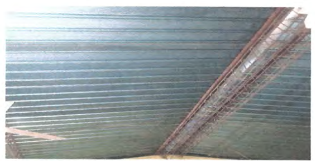
Foto 4: ESTRUCTURA DE TECHO- Salones de preprimaria, posee escasa estructura y deteriorada.
