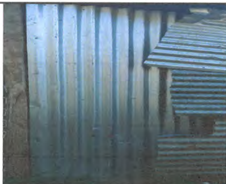
Foto 3: Sustrucción de puerta en área de cocina
