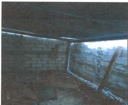
Foto 1: Sustrucción de lámina en área de cocina
