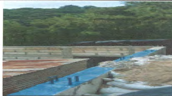
Foto 6: Sustrucción de balcones en el área de cocina
