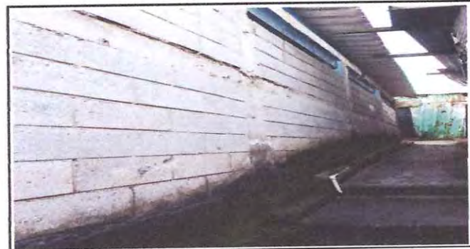
Repello gris en pared exterior con moho y fisuras
