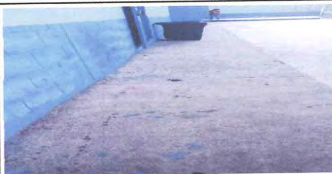
Instalación en pasillo izquierdo
