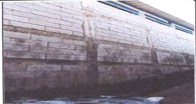
Repello en pared exterior con moho y fisuras
