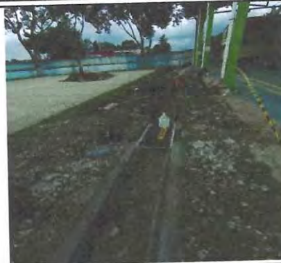
Foto: 2 Rejilla para cuneta
