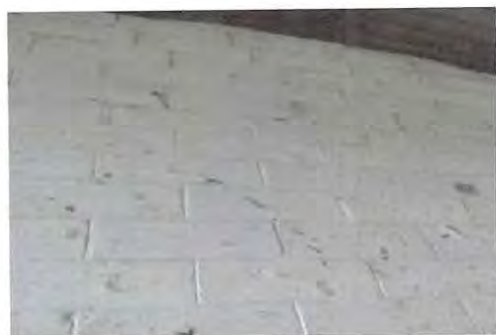
Foto: 9 Quitar la pared ,por desplome del temblor.
