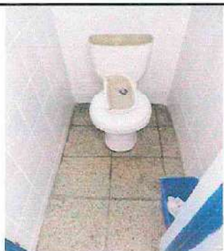
Foto 33: Sustrucción de inodoro: Sustrucción de inodoro en el baño de maestros, módulo 2
