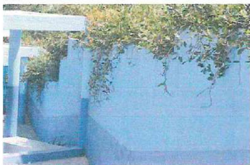
Foto 35: Muro perimetral: Corte de hiedra en muro perimetral, módulo 2
