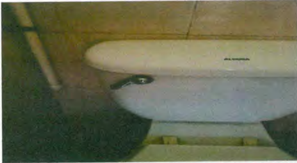
FOTO 13: sustitucion de manija de descarga de sanitario pvc 1/2 x 30 cm cromada
