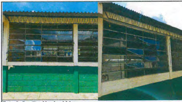
Foto 6: Sustrucción de vidrios.
