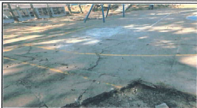
Foto 2: partes faltantes que son un riesgo para la poblacion estudiantil
