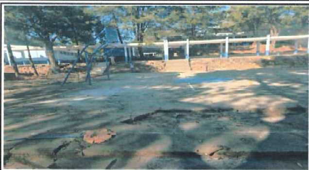
Foto 1: partes faltantes en la cancha
