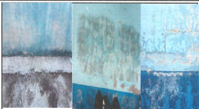
FOTO 1: RESANE EN MUROS Y REPELLO
