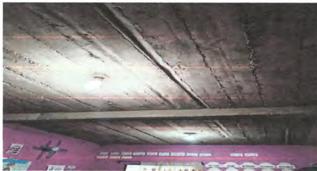
Foto 5: cernido en techo de aulas Y pintura
