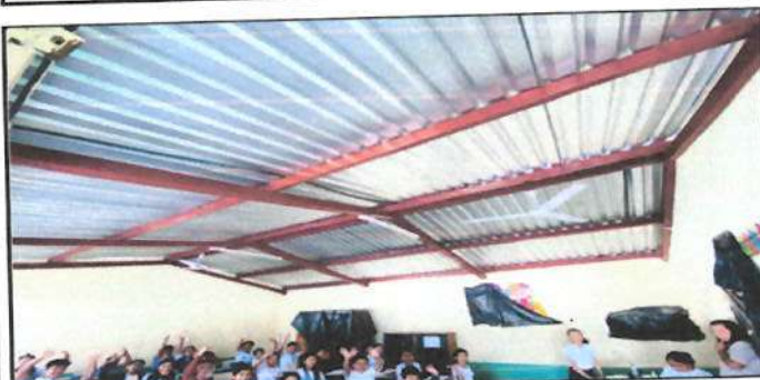
Foto 3: lámina de Aula 4rto primaria 2do nivel deteriorada, con filtraciones / TERMINADO
