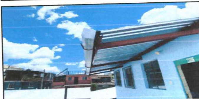
Foto 4: Canal pluvial de aula 4rto Primaria deteriorado / TERMINADO
