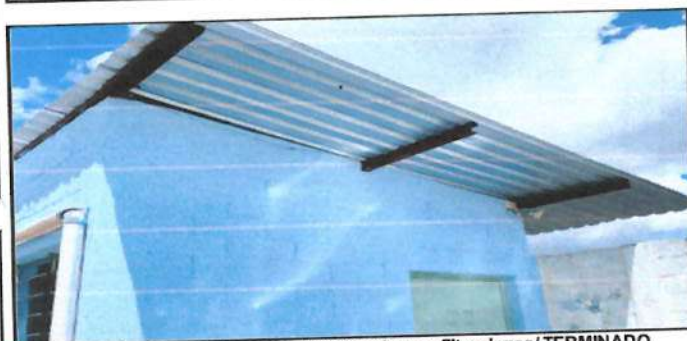
Foto 5: Lámina de área de cocina deteriorada, con filtraciones / TERMINADO
