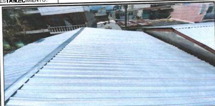
Foto 1: Lámina de área de baños deteriorada, con filtraciones / TERMINADO
