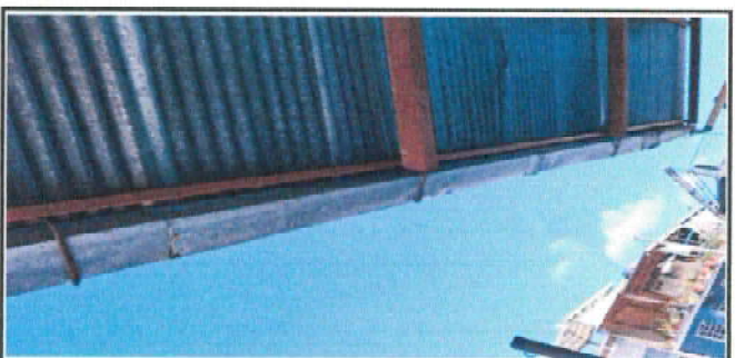
Foto 4: Canal pluvial de aula 4to Primaria deteriorado
