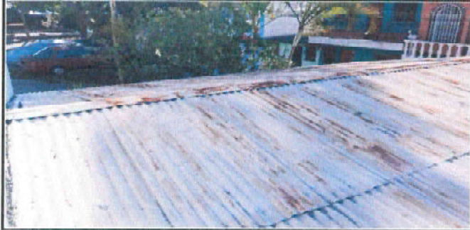
Foto 1: Lamina de area de baños deteriorada, con filtraciones
