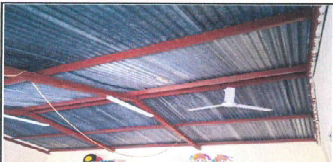
Foto 3: lamina de Aula 4to primaria 2do nivel deteriorada, con filtraciones
