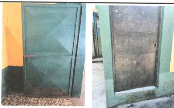
Foto 3: 4.1 REPARACION DE PUERTAS, INCLUYE SUSTITUIR UNA FRANJA DE 20 CM EN LA PARTE INFERIOR
