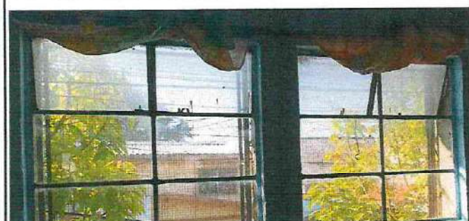
Foto 3: Los balcones actuales son de cedazo, en su mayoría están oxidados o picados.
