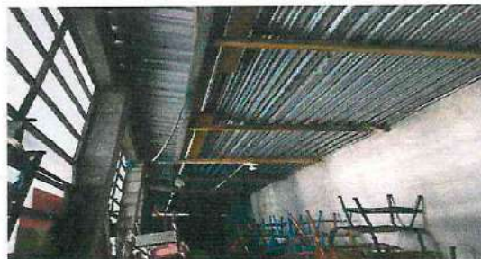
Foto 2: El techo de la bodega se encuentra en las estado, provocando en invierno filtraciones. Se sustituirá la medera por metal.
