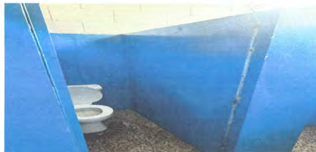
Foto 4: Puertas de baño
