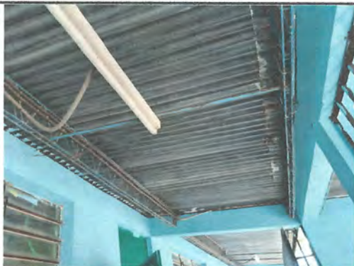
Foto 7: Sustrucción de lamparas
