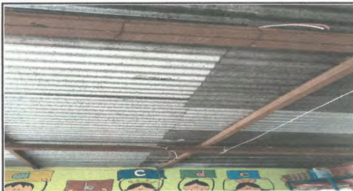
Foto 2: COSTANERAS DAÑADAS POR LA OXIDACIÓN
