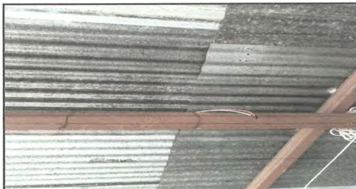
Foto 3: COSTAÑERAS DAÑADAS POR OXIDACIÓN
