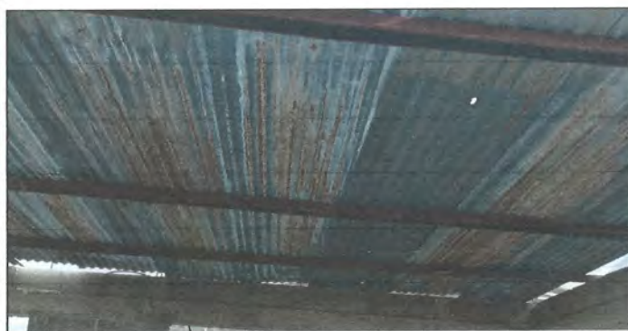
Foto 5: LAMINAS CON FILTRACIÓN DE AGUA
