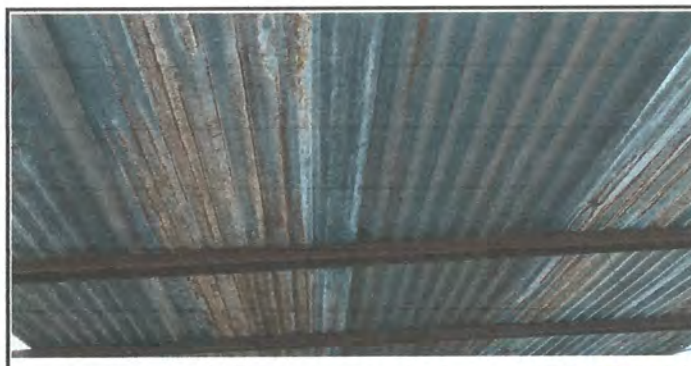
Foto 6: TECHOS CON OXIDO
