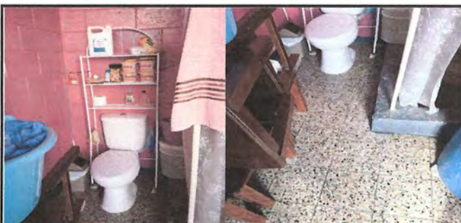
FOTO 6: Reubicar Sanitario y hacer nuevos drenajes
