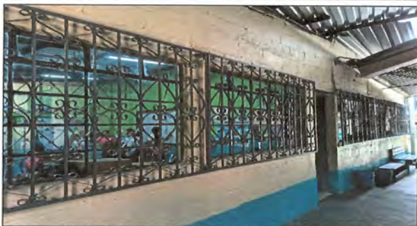
Foto 7: Materiales y mano de obra de: Limpieza de pared, ensavietado, emparejado de pared con monocapa gris y cernido blanco con monocapa fino. 2do. A y 6to.
