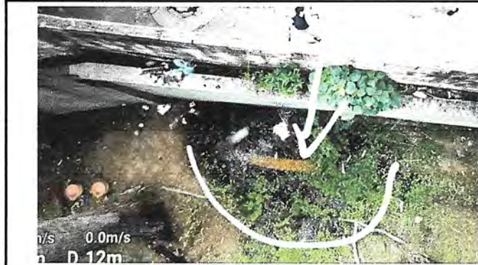
Foto 1: filtración a un costado del establecimiento en dirección a la Universidad Rafael Landívar.
