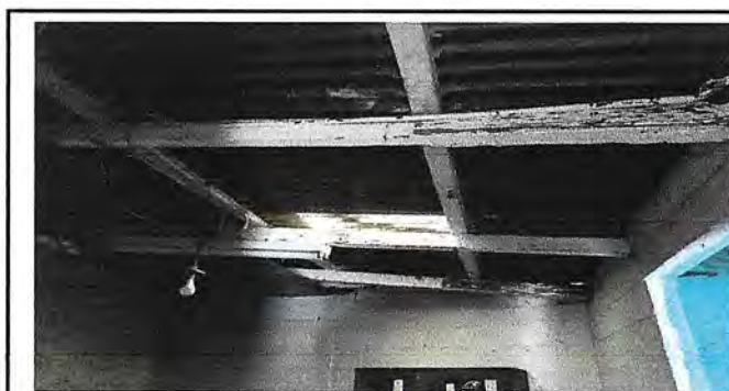
Foto 5: lámina que necesita reemplazo.
