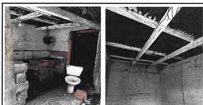
Foto 6: área de techo y pasillos que necesita cambio de lámina.
