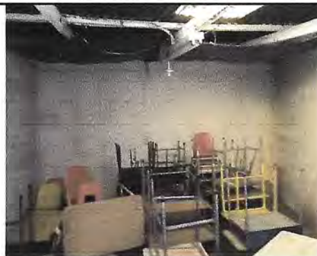
Foto 8: aulas que requiere cambio de costaneras.
