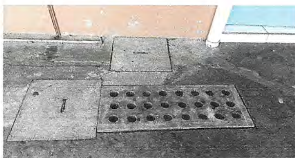
Foto 3: Limpieza de reposaderas ya que están llenas de hojas de árboles.
