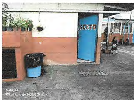
Foto 3: Se pintará todo el interior del establecimiento por deterioro.
