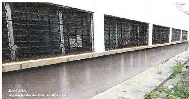
Foto1: Se pintará el exterior del edificio escolar por deterioro.
