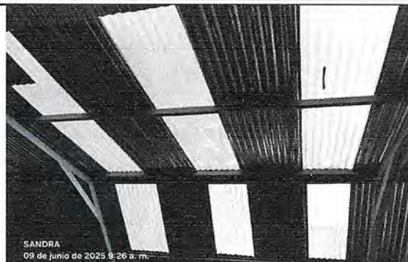
Foto 2: Se cambiarán las láminas de policarbonato transparente, ya que muestran desgaste y se entra el agua.
