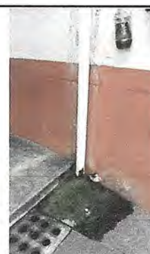
Foto 6: Se cambiará el tubo porque está quebrado y presenta fuga de agua en una zona no adecuada.
