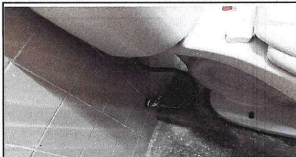
Foto 2: Conexión de sanitarios
