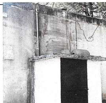
Foto 4: Tubería y espacio donde se encuentra la bomba de agua
