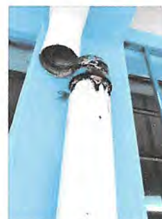
Foto 6: bajadas de agua en mal estado
