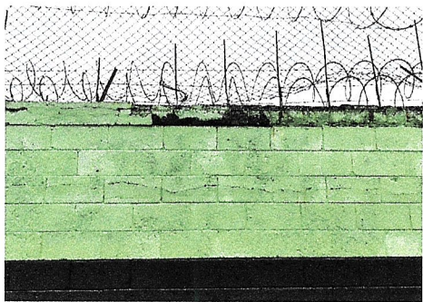
Foto 1: REPARACION DE MURO PERIMETRAL EN MAL ESTADO.
