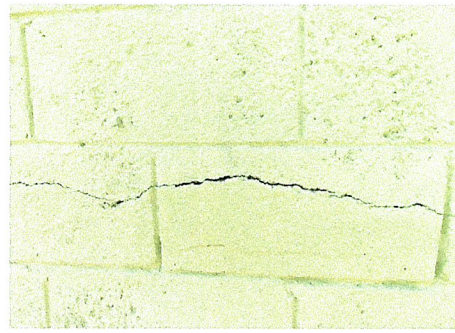
Foto 2: REPARACION DE MURO PERIMETRAL EN MAL ESTADO.
