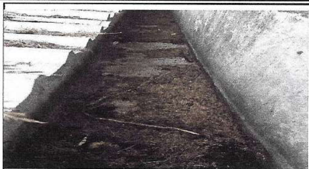
Foto 1: CANAL DE CONCRETO A REMOZAR ALA NORTE
