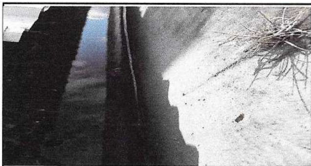
Foto 3: CANAL DE CONCRETO A REMOZAR ALA OCCIDENTE
