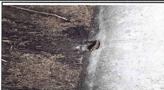
Foto 2: CAIDA DE AGUA A REMOZAR ALA NORTE DE TALLERES
