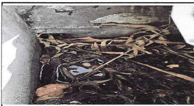
Foto 4: CAIDA DE AGUA A REMOZAR ALA OCCIDENTE
