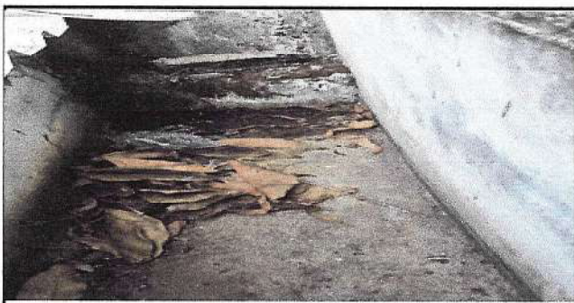
Foto 5: CANAL DE CONCRETO A REMOZAR ALA OCCIDENTE
