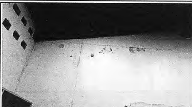
Foto 2: La pintura de las paredes presenta un deterioro debido a diversas causas, incluyendo filtraciones de agua y el desgaste natural por el paso del tiempo.
