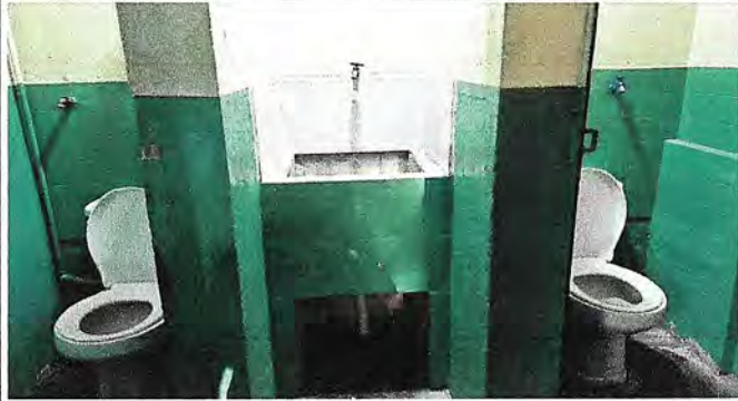
Foto 1: Sanitarios de Niñas en mal estado y falta de azulejo en los mismos.
