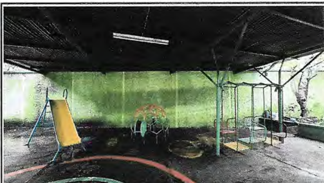
Foto 4: La estructura del área de juegos representa un riesgo para la seguridad por deterioro de la estructura de techo.
