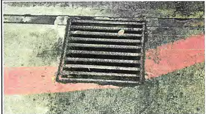
Foto 4: La falta de mantenimiento y el difícil acceso para llevarlo a cabo han provocado la obstrucción del sistema de drenaje.
