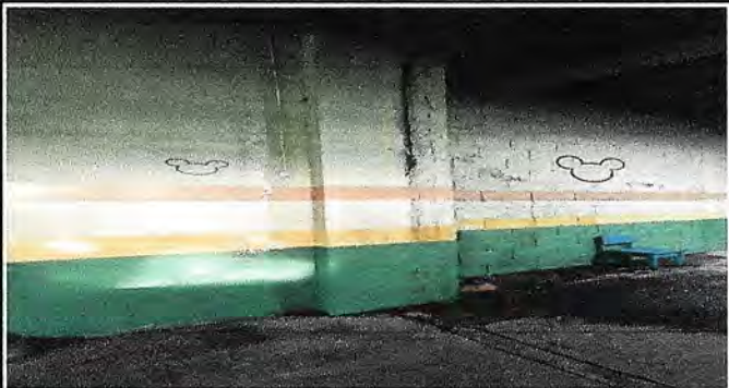
Foto 1: Humeda y filtraciones en paredes del área.
