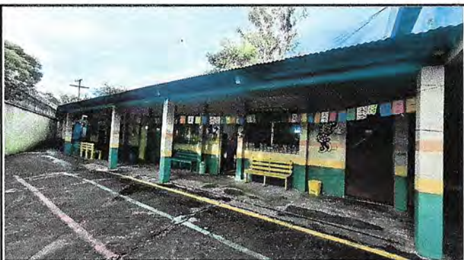
Foto 3: Ausencia de un sistema de canalización para aguas pluviales.
