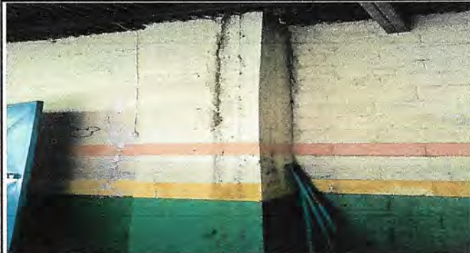
Foto 2: Daño en la estructura del establecimiento.
