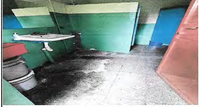
Foto 2: Sanitarios de Niños en mal estado y falta de azulejo en los mismos.
