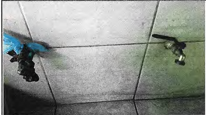
Foto 4: Los chorros presentan un deterioro severo y requieren remplazo.
