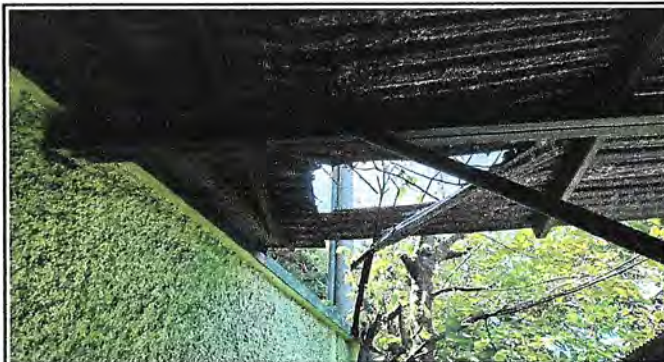
Foto 5: Las láminas del área de juegos presentan daños severos, consecuencia de la corrosión y el paso del tiempo, lo que ha ocasionado su ruptura.
