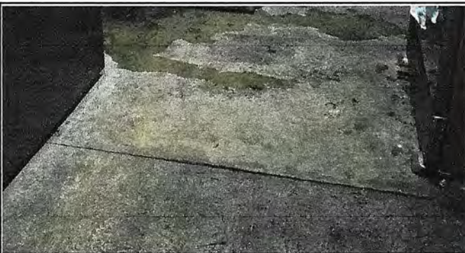
Foto 5: Cocina con el piso en un estado deteriorado y peligroso por fugas de agua de la pila.
