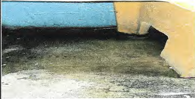
Foto 1: Fugas de agua en la pila de la cocina.
