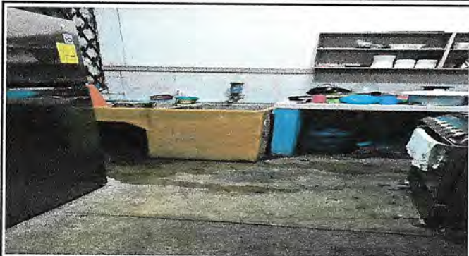
Foto 1: El área de la cocina está en mal estado por el tiempo de uso y no tiene espacio suficiente para cocinar, por lo que requiere una remodelación.
