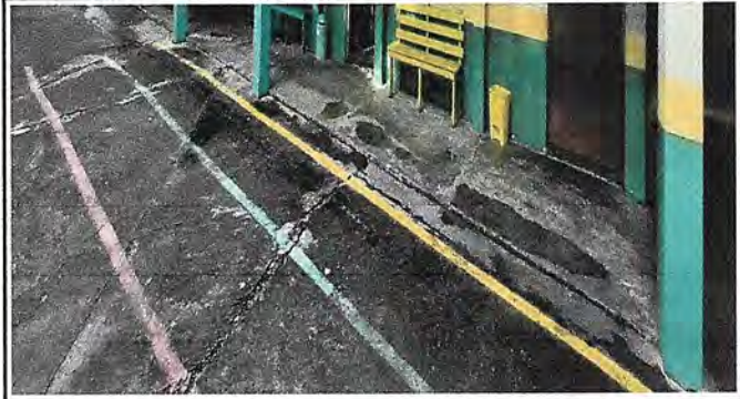
Foto 2: Losa del área de juegos con un deterioro debido a su antigüedad y a la exposición directa a las descargas de aguas pluviales.
