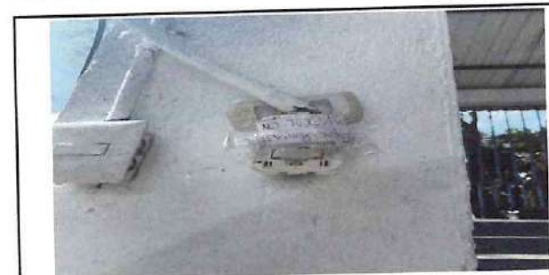
Foto: 6 Switch de lamparas de patio central
