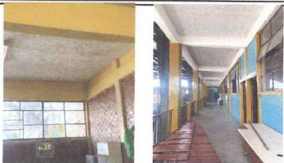
Foto: 1 Losa de aulas en mal estado segundo nivel + pasillo
