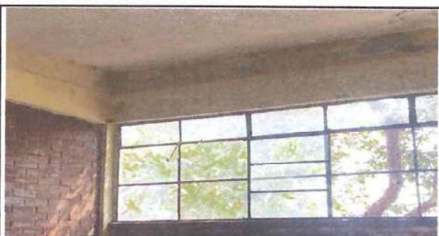
Foto: 5 Pintura de interior de aulas area dañada.
