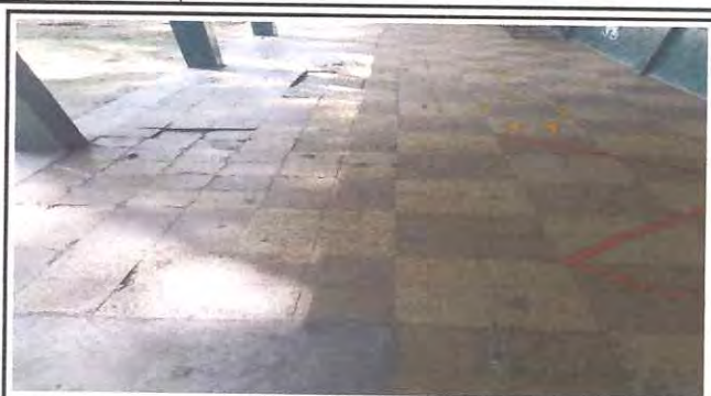
Foto: 2 Aquí se puede observar que ya es un peligro para el edificio, por las raíces que están levantando el piso y en otros el hundimiento
