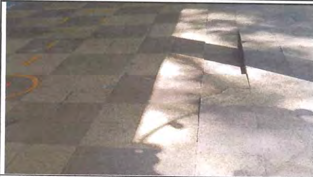
Foto: 1 Se puede observar el hundimiento que existe en los azulejos
