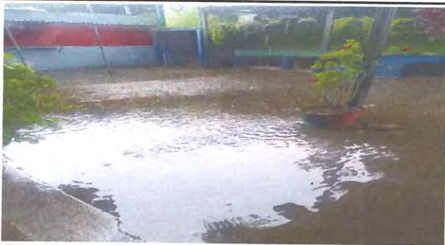
Foto: 3 El drenaje colapsado, se encuentra tapado por ser una instalación antigua, deben ser nueva instalación.
