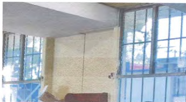
Foto: 2 Las ventanas son de paletas y ya no cuentan con el mecanismo para abrir y cerrar.
