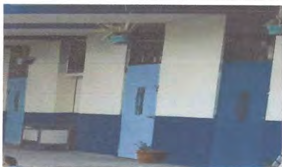
Foto: 3 Ventanas y balcones muy deterioradas
