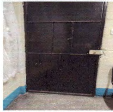
Foto: 2 Reparación de puerta y dintel de ingreso a dirección dañados
