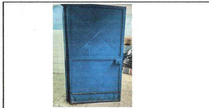
Foto 6: Puerta de sanitario de varones
