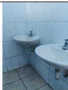
Foto 2: LAS MEZCLADORAS NO FUNCIONAN Y TIENEN FUGA, TAMBIÉN ES NECESARIO UN CARGADOR PARA ASEGURAR LOS LAVAMANOS
