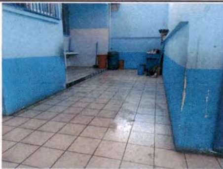
Foto 1: ES URGENTE LA INTALACION DE UNA REPOSADERA, CUANDO SE HACE LIMPIEZA NO SE TIENE PARA DONDE TIRAR EL AGUA
