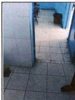
Foto 3: EN AMBOS MÓDULOS DE BAÑOS ES NECESARIO COLOCAR UNA REPOSADERA, CUANDO SE HACE LIMPIEZA EN LOS BAÑOS, EL AGUA DE ESTOS PASAN POR DONDE LOS NIÑOS RECIBEN CLASES
