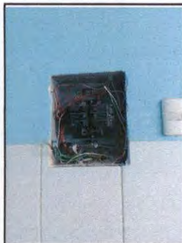
Foto 1: REVISIÓN DE TABLERO ELÉCTRICO Y COLOCACIÓN DE TAPADERA, ACTUALMENTE LOS CABLES ESTÁN EXPUESTOS
