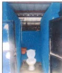
Foto 4: azulejo y piso en los sanitarios
