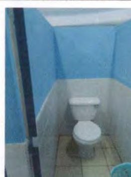
Foto 4: SANITARIOS EXISTENTES EN SERVICIOS SANITARIOS DE NIÑAS Y NIÑOS, SE SUSTITUIRAN POR MAL FUNCIONAMIENTO EN EL TANQUE GENERANDO CONSUMO EXCESIVO DE AGUA.
