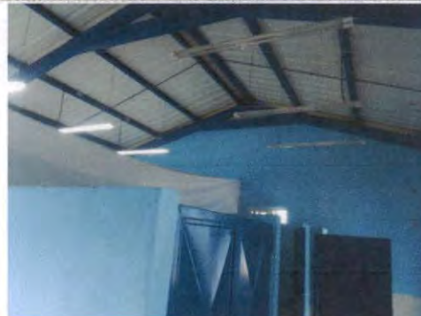
Foto 2: USAID DISEÑO MAL EL AREA DE LOS SANITARIOS POR TAL MOTIVO SE NECESITA LEVANTAMIENTO DE MURO.
