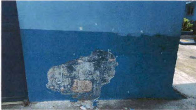
Foto 7: SITUACION ACTUAL DE MURO EXTERNO EN SERVICIO SANITARIO, SE NECESITA REPARACION DE ACABADO.
