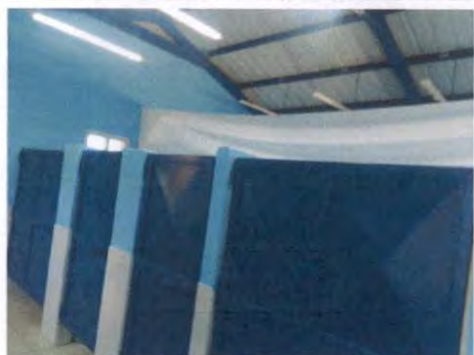
Foto 3: USAID DISEÑO MAL EL AREA DE LOS SANITARIOS POR TAL MOTIVO SE NECESITA LEVANTAMIENTO DE MURO.
