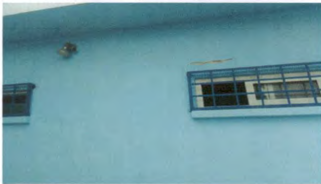
Foto 9: SITUACION ACTUAL DE MURO EXTERNO EN SERVICIO SANITARIO, SE NECESITA REPARACION DE ACABADO.
