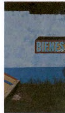
Foto 10: SITUACION ACTUAL DE MURO PERIMETRAL COLINDANTE, ES NECESARIO REFORZARLO.
