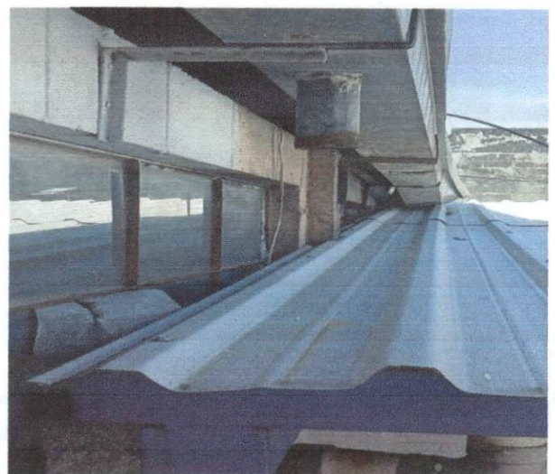
VISTA DE JUNTA DE LÁMINAS DONDE SE COLOCARÁ UN SELLO PARA EVITAR INGRESO DE AGUA DE LLUVIA AL VESTIDOR DEL SUM
