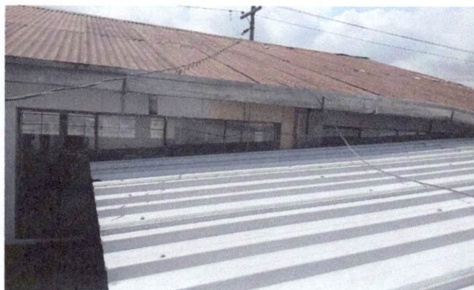
LÁMINAS EN EL SUM LA CANALETA SE CAMBIARÁ COMPLETA
