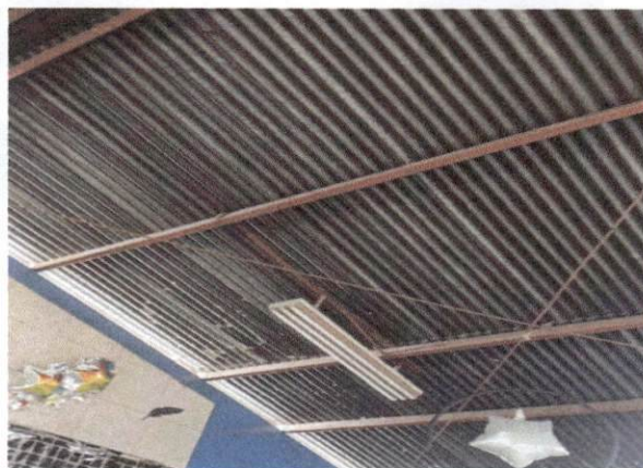
VISTA DE LÁMINAS CON AGUJEROS QUE PROVOCAN GOTERAS.
