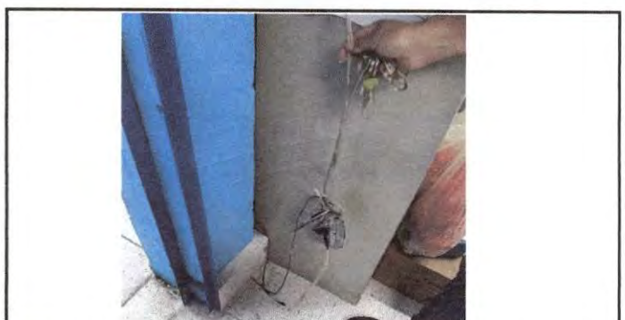
Foto 6: SUMINISTRO E INSTALACION DE ACCESORIOS PARA INTERCOMUNICADOR (ACTUALMENTE SE ENCUENTRA SOBRE PUESTOS Y LOS CABLES DE ELECTRICIDAD ESTAN EXPUESTOS)
