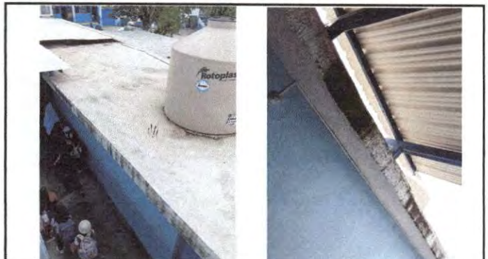
Foto 4: REPARACION DE CENEFA SOBRE LOSA (ACTUALMENTE EL AGUA PLUVIAL CAE EN EL PASILLO LO QUE DIFICULTA EL PASO PARA ALUMNOS Y MAESTROS )
