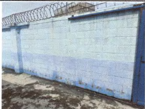
Foto 1: pintura en paredes del exterior de las aulas de la escuela deteriorada por ser de mala calidad.
