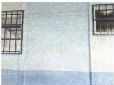
Foto 3: pintura en paredes internas en deterioro.
