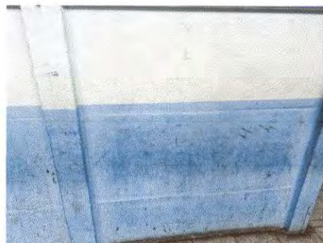
Foto 2: zócalo en deterioro, se cambiara a pintura de aceite.
