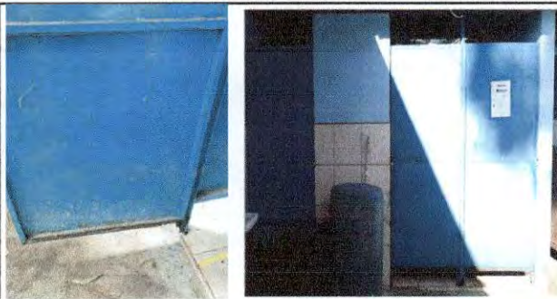
puertas de sanitarios clase 10
