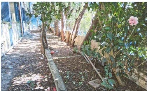
Foto 1: Se observa espacio tipo jardín en la EODP con arboles tipo ciprés que afectan delimitación de muro perimetral.
