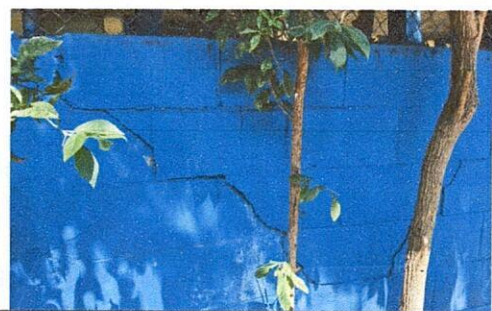
Foto 5: Se observa grietas en delimitación perimetral en todo el trayecto del muro que divide ambas escuelas.
