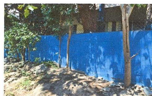
Foto 6: Se observa grietas en delimitación perimetral en todo el trayecto del muro que divide ambas escuelas.
