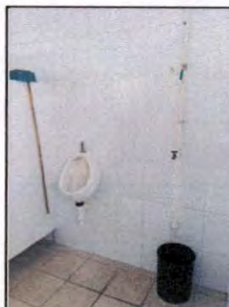
Foto 4: URINAL UBICADO EN SERVICIOS SANITARIOS DE NIÑAS, SE NECESITA HABILITAR OTRO INODORO Y ELIMINAR DICHO URINAL
