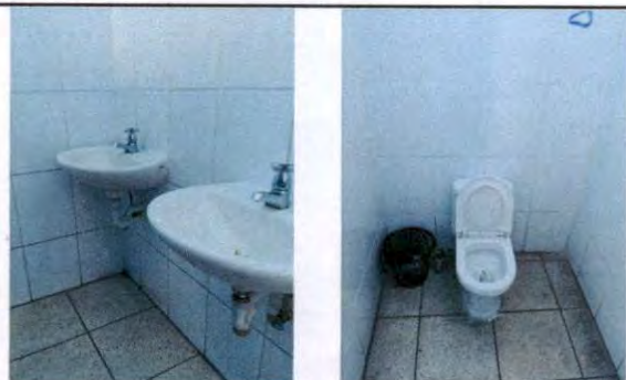
Foto 2: LAS MEZCLADORAS NO FUNCIONAN Y TIENEN FUGA, TAMBIEN ES NECESARIO UN CARGADOR PARA ASEGURAR LOS LAVAMANOS
