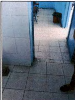
Foto 3: EN AMBOS MODULOS DE BAÑOS ES NECESARIO COLOCAR UNA REPOSADERA, CUANDO SE HACE LIMPIEZA EN LOS BAÑOS, EL AGUA DE ESTOS PASAN POR DONDE LOS NIÑOS RECIBEN CLASES
