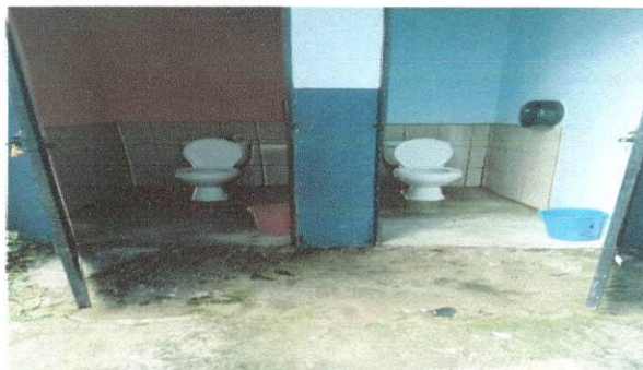
Foto1: CAMBIO DE AZULEJO DE BAÑO DE VARONES Y NIÑAS , POSIBLES FUGAS Y DRENAJES
