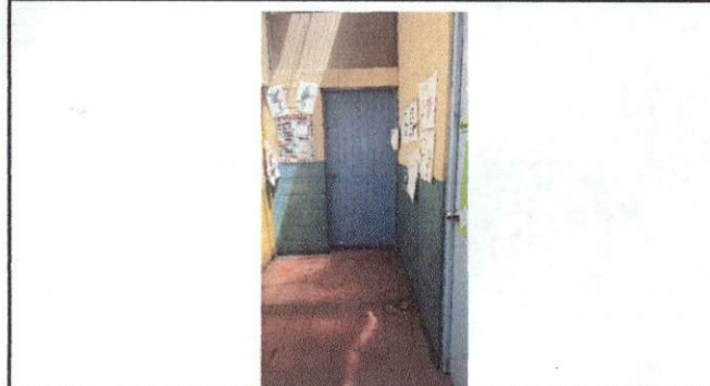
Foto 2: Estado actual de muros interiores, donde se aplicara pintura
