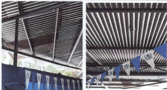
Foto 1: Area de laminas en mal estado que seran sustituidas
